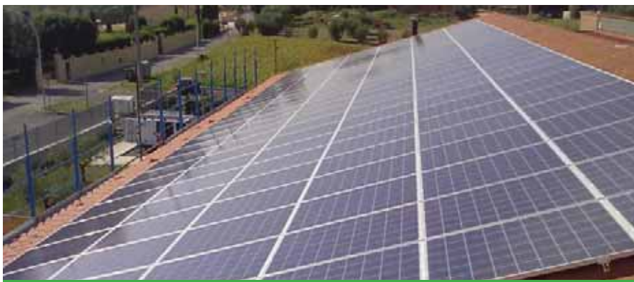
Vista dei pannelli sul tetto della scuola
